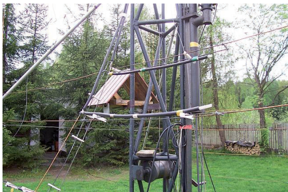
Kołowrotek do spuszczenia anteny na suwakach zamontowanych na jednej krawędzi kratownicy
